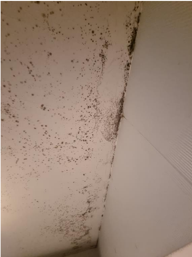
← Slaapkamer plafond, rechts, buitenmuur
