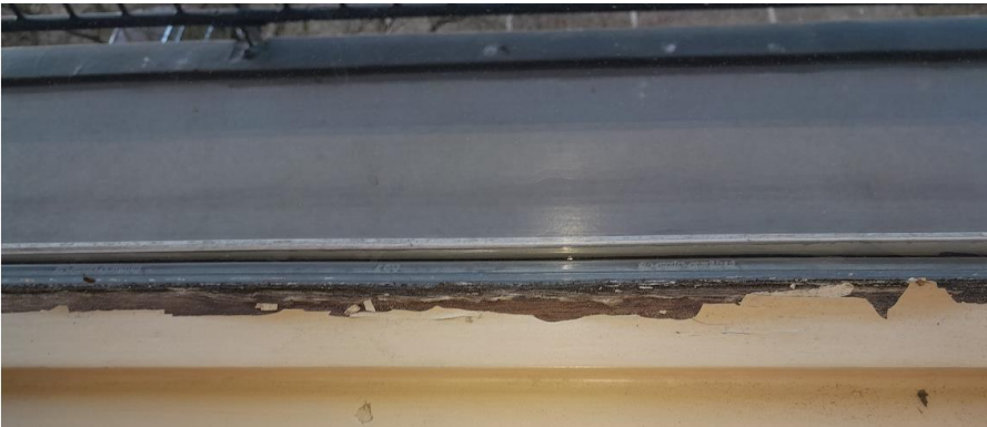
Houtrot van de kozijnen
